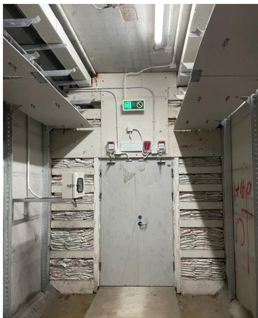
与干线、支线综合管廊衔接处防火隔断和防火门
